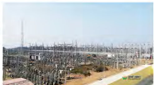
चित्र 11.32: धनुषा, ढल्केवरमा अवस्थित 400 kV सब स्टेशन
